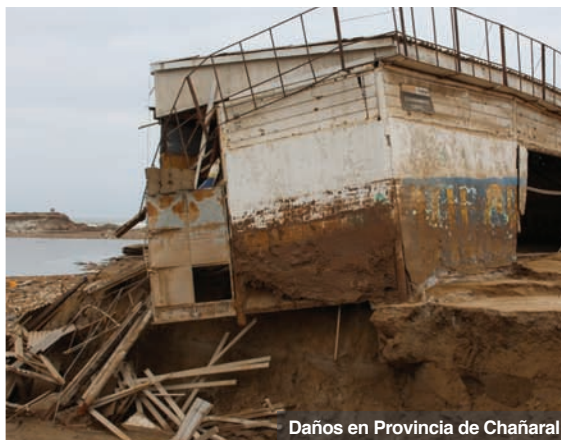
Daños en Provincia de Chañaral
